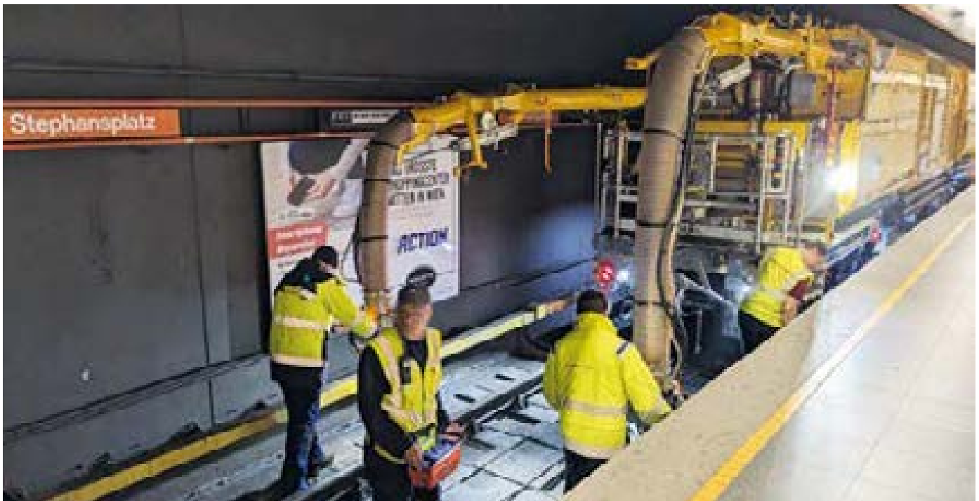
Abb. 4: Das System arbeitet mit drei Bedienern für den Einsatz der Handschläuche bzw. die Fernsteuerung des Saugbalkens.
