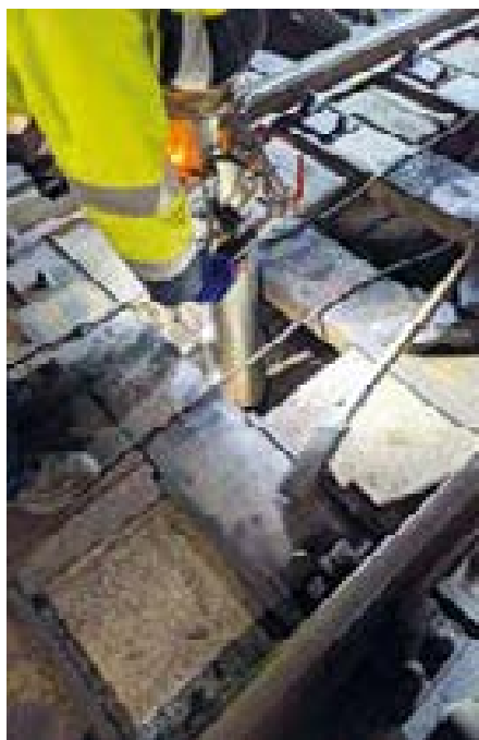
Abb. 5: Am Ende der Saugschläuche befinden sich Blasluftleitung, Beleuchtung und Bedieneinheit.
